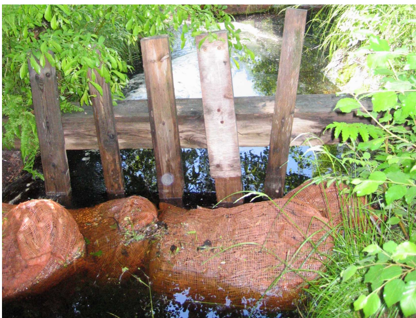
Kuva 3.1.3. Puurakenteinen hakesuodatin Kotaojalla 1.7.2005.
