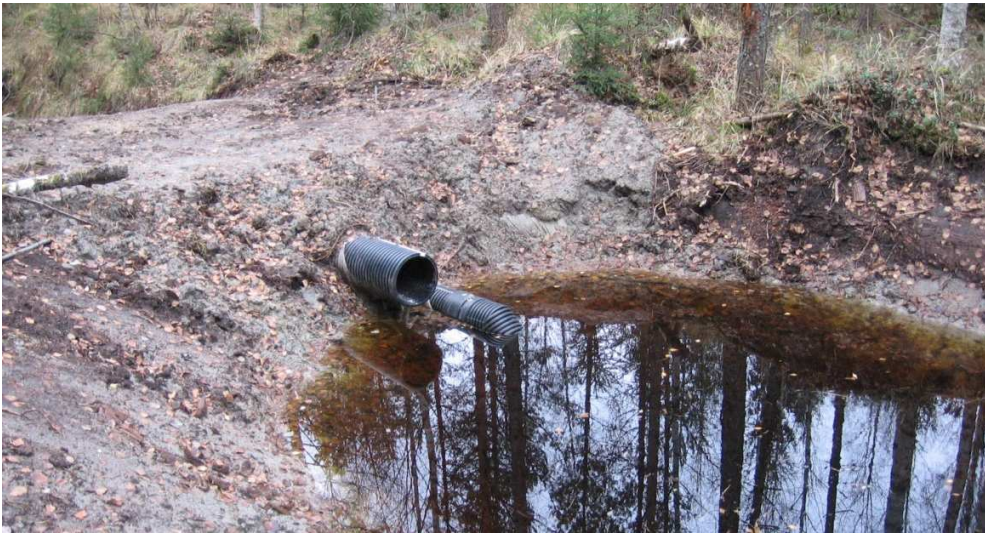
Kuva 11. Putkipato maastossa. Putkipato koostuu alempana olevasta padottavasta putkesta ja ylempänä olevasta ylivuotoputkesta.
